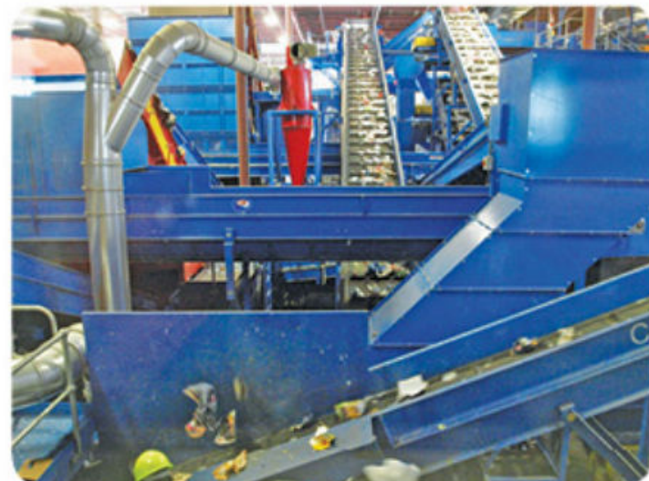
1.20. Planta donde se recicla plástico poliestireno. La diferencia de densidades entre los distintos tipos de plástico es la base para su separación.
